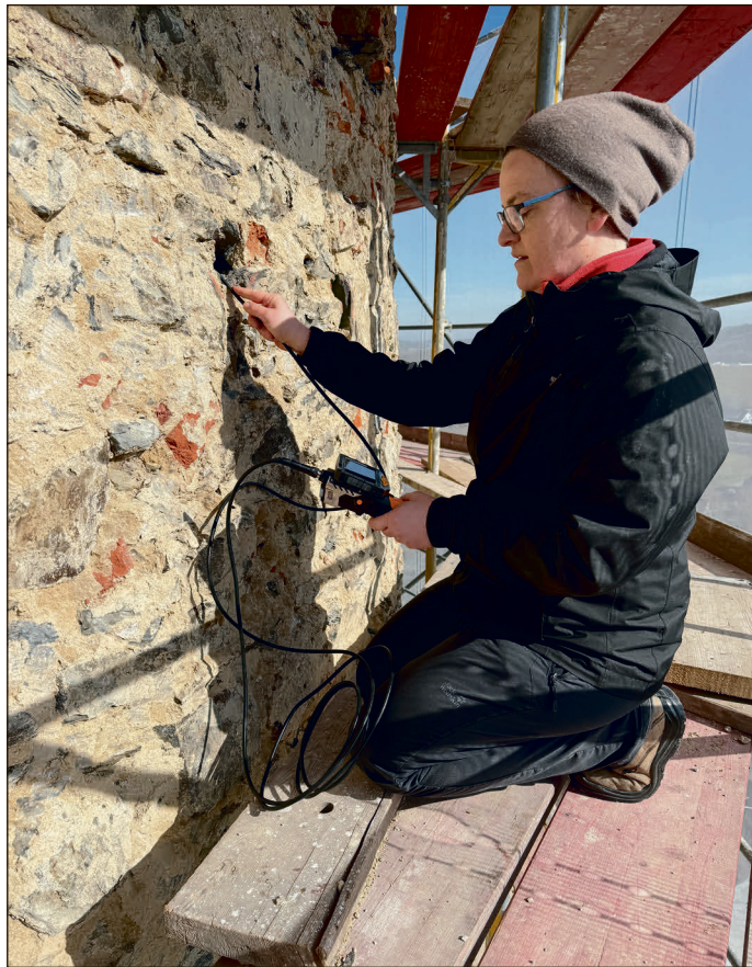
Fachgutachterin Anja Rohland kontrolliert die Löcher mit der Endoskop-Kamera.
