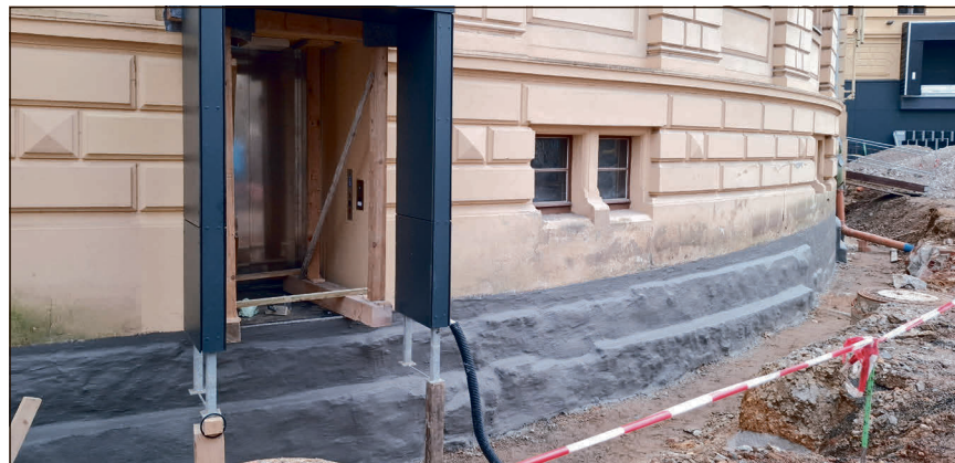
Der Personenaufzug ist eingebaut und betriebsbereit.
